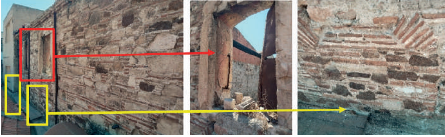
Fot. 21,22,23. Kuzey cephedeki kapatılan pencerelerden bazılarının dıştan görünimleri
